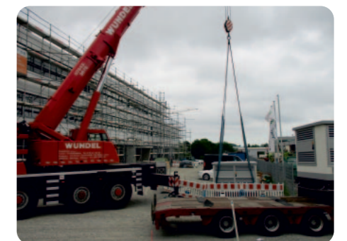
Die Anlieferung der Trafostation erfordert Präzision vom Team Netzbau des Regionalwerks Bodensee.
